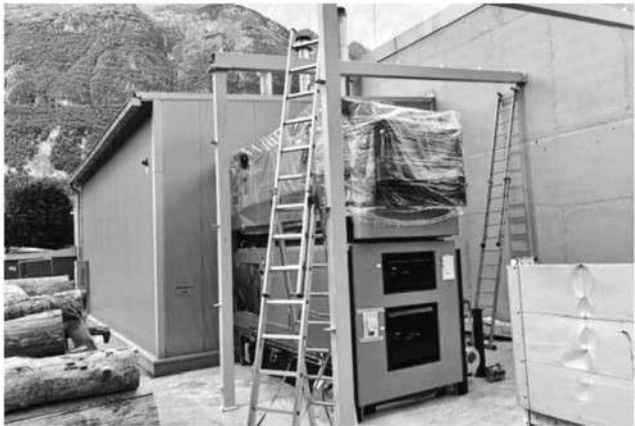
ŠIRITEV KOTLOVNICE DOLB BOVEC JE POVEČALA ZMOGLJIVOST SISTEMA, OMOGOČILA CELOLETNO OSKRBO S TOPLOTO TER SKORAJ NIČELNE IZPUSTE PRAŠNIH DELCEV, hkrati pa je bilo uvedeno tudi daljinsko upravljanje toplotnih postaj pri odjemalcih.
